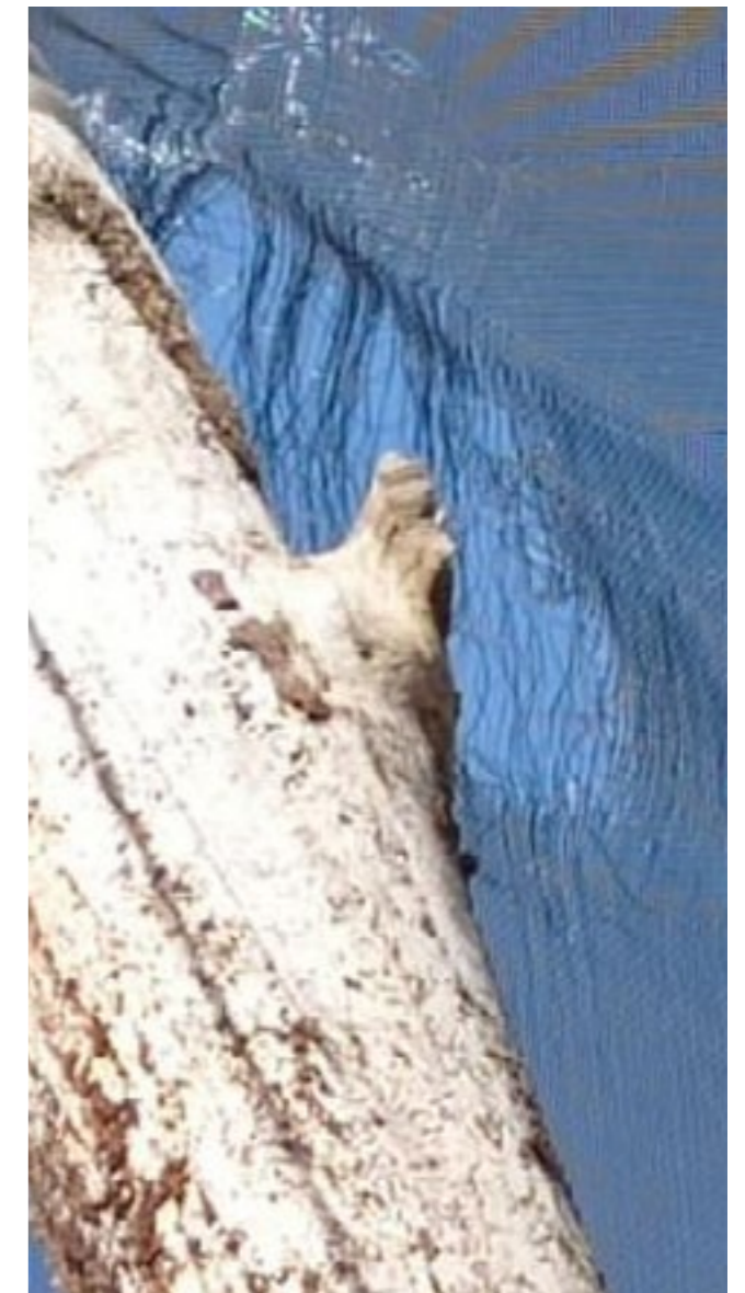
Ilustración 19: RASGADURA DE MALLA SOMBRA
